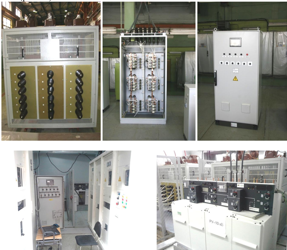
Рис. 37. Силовое оборудование подстанции НГТУ им. Р.Е. Алексеева
